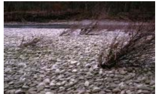
Grobe und stark abgeplästerte Deckschicht in der Restwasserstrecke des Aare-Kraftwerks Wildegg-Brugg
